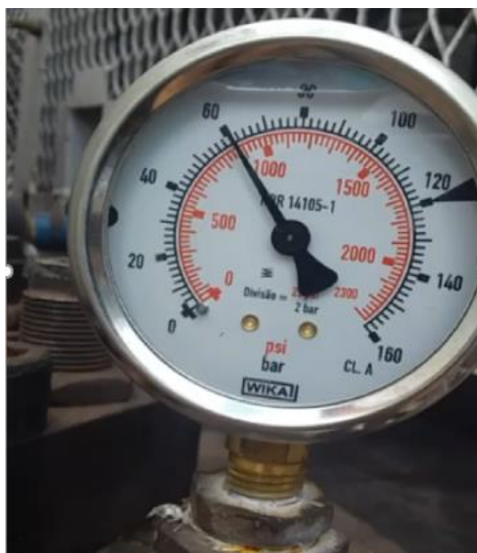
Manômetro em operação com pressão de 60 BA
